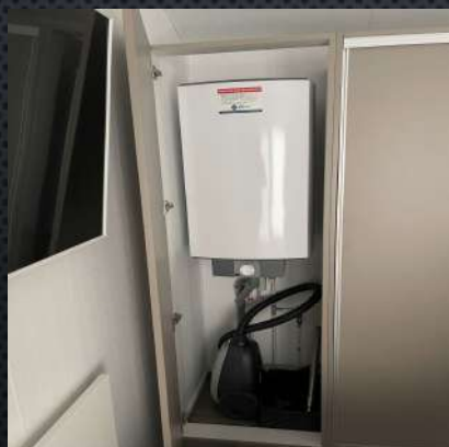
Elektroboiler 80 Liter mit Booster Aufheizung
